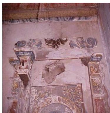
Foto 6 - Detalhe de um dos altares laterais antes do restauro
