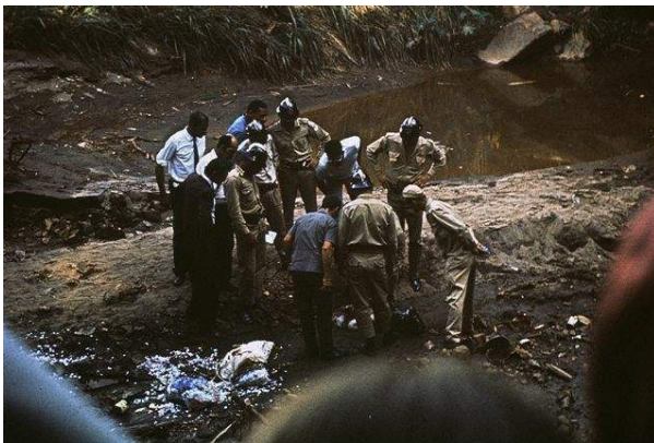
Trabalho realizado em Belo Horizonte, Minas Gerais, em 20 de abril de 1970. LOCAL: em um rio/esgoto, colocação de 14 T.E, Parque Municipal.
